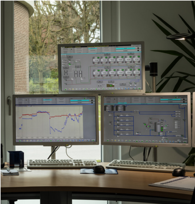
Über ein sicheres VPN ist die Druckerhöhung in die zentrale Prozesssteuerung der Wasserversorgung in den Wasserwerken integriert
