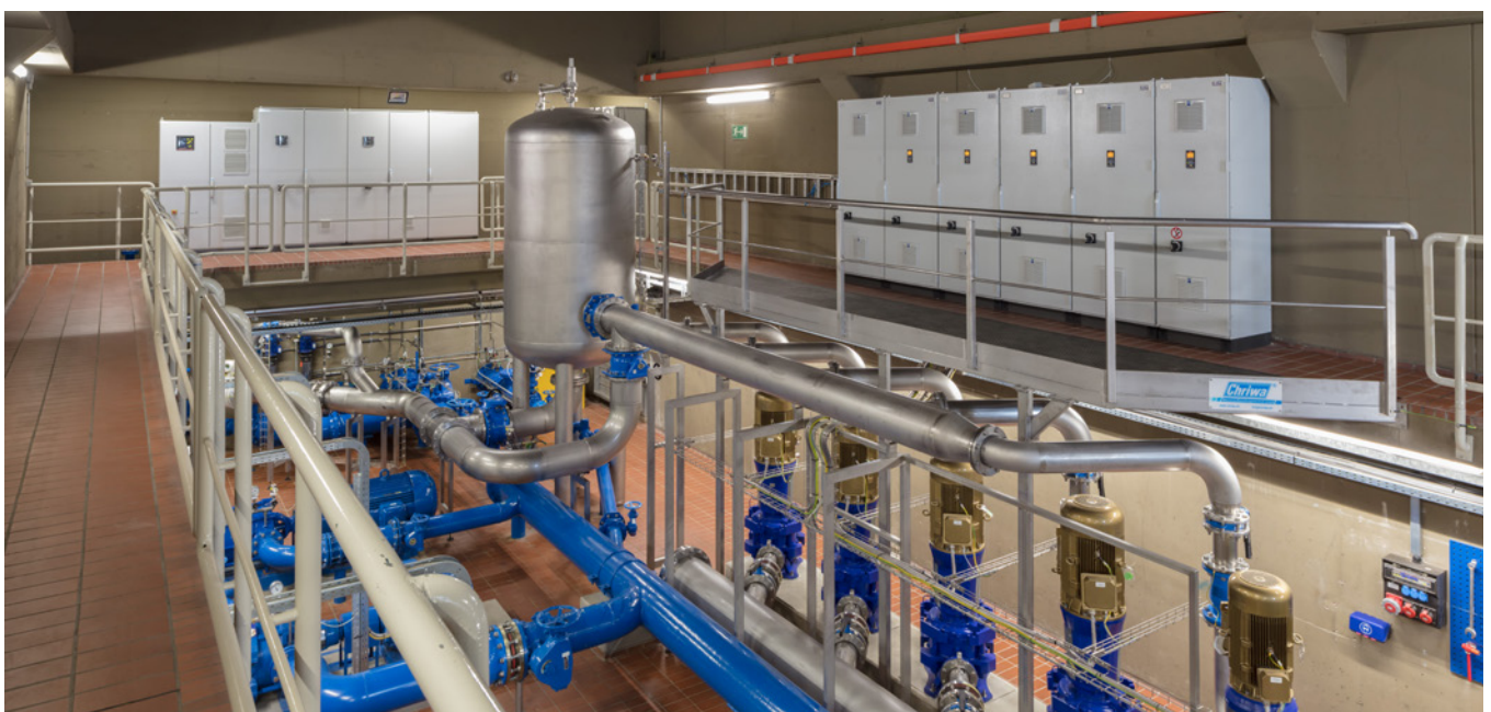
Die neue Druckerhöhungsanlage der Stadtwerke Münster ersetzt den historischen Wasserturm „Auf der Geist“
